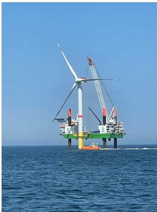
Rys. 8. Morska turbina wiatrowa (serwis) Morze Północne
