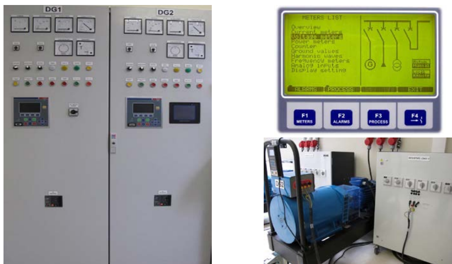
Rys. 1. Widok rozdzielnic głównej, ekranu systemu SYMAP ECG, zespołów prądotwórczych wraz z blokiem obciążenia RL
